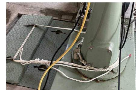
天板落下防止対策
